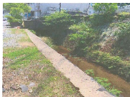
⑥ 柵がなく転落の危険あり
