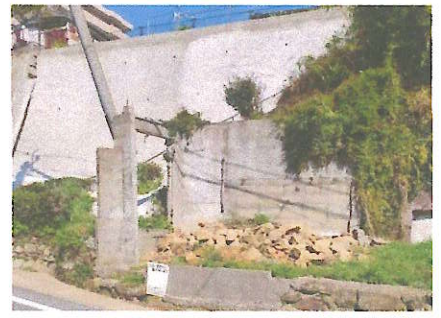
⑫ 高さのあるコンクリート塀があり危険
